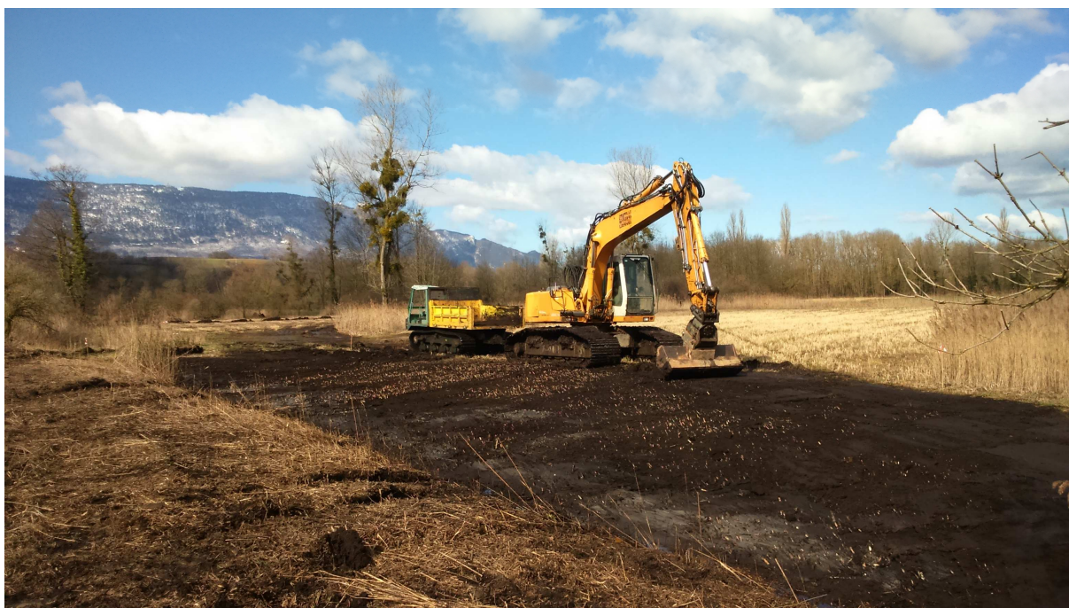
Pelle avec moteur d'orientation et godet de curage. Reprofilage de berges et évacuation des matériaux avec dumper chenillé
