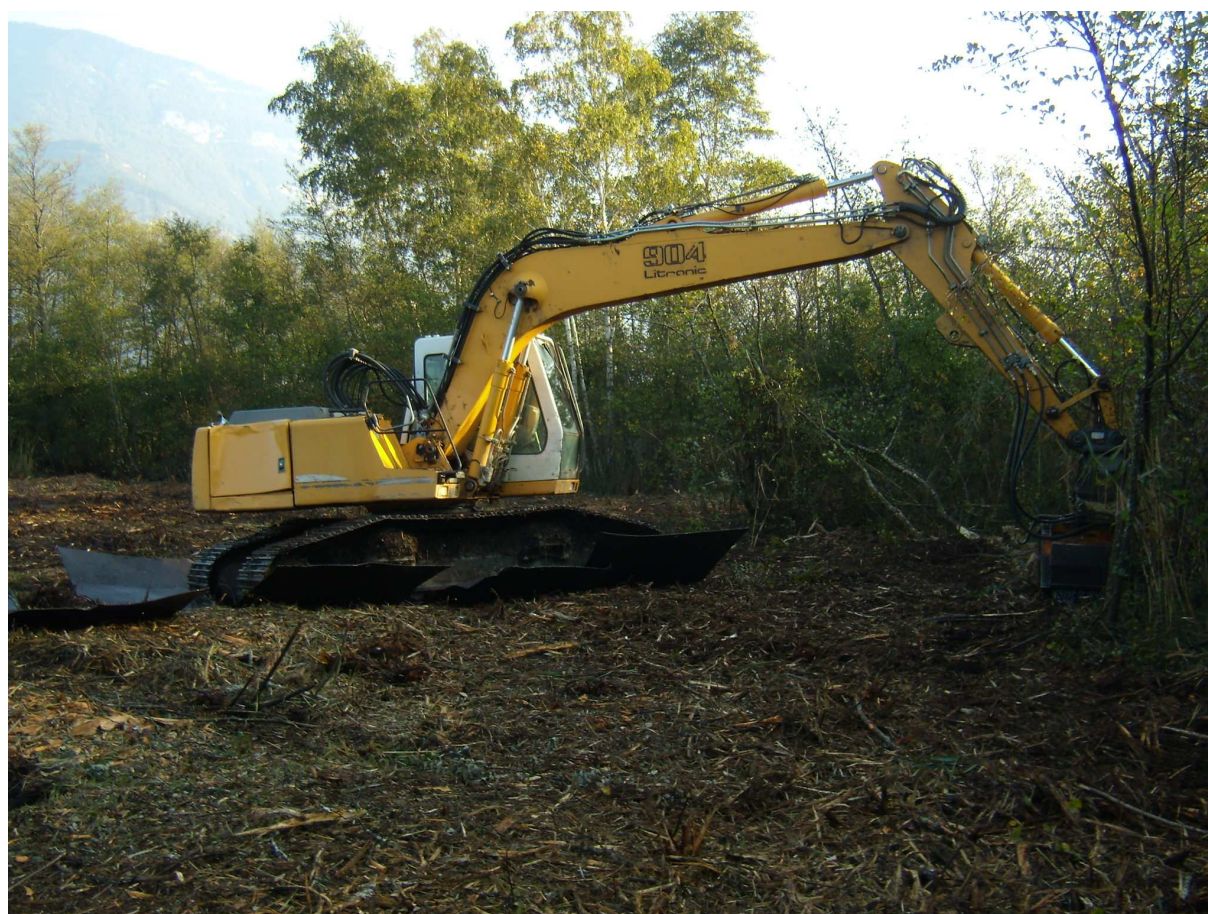
Utilisation des caillebotis pour broyage sur sol très peu portant (anciennes fosses d'extraction de tourbes)
