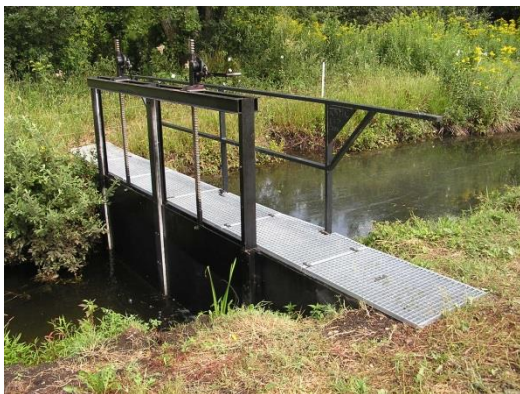
Grande vanne sur le fossé Meunier
